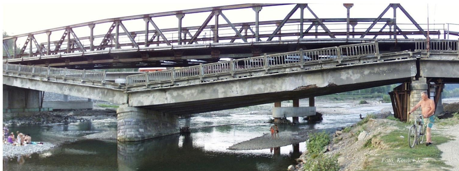
HUSZT A '98 őszi árvízben megsérült híd
